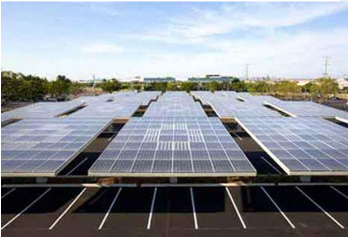
« Solar Grove », San Diego, Californie. Le parc de stationnement du siège de Kyocera pour l'Amérique du Nord comprend un système de production électrique solaire de 25 panneaux et 235 kilowatts, qui fournit également de l'ombre à 186 véhicules. (Copyright 2007 Kyocera Solar, Inc. Tous droits réservés.)
